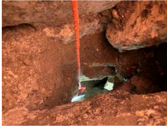
Detail van linkerfoto: holle ruimte bij de scheur, van bovenaf gefotografeerd. Peilstok zichtbaar en ruimte kunstmatig verlicht
